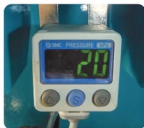
エアシールの圧力表示計
