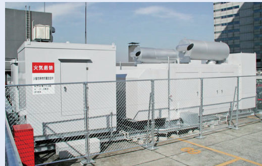
自家発電設備
